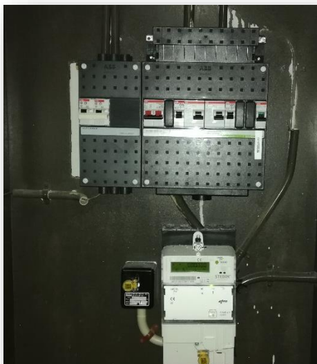
Meterkast in de gang
